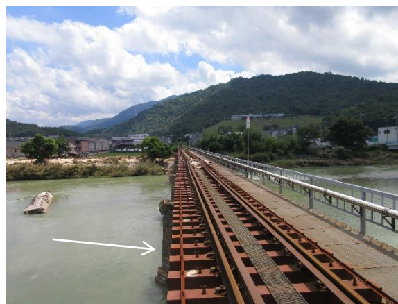
芸備線の橋梁中央部の変形
