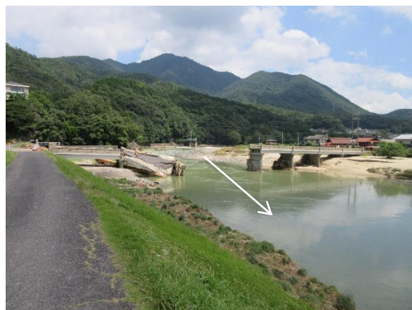
落橋した道路橋の様子
