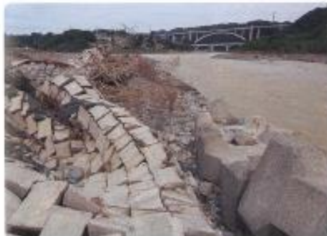
大雨でふえた水によってこわされた堤防 [神奈川県 相模原市 相模川 2007年]
