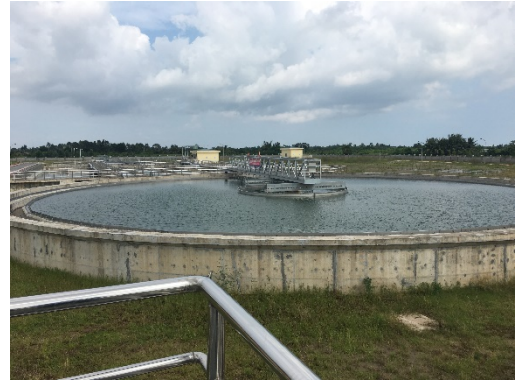
写真-4 下水処理場の様子
