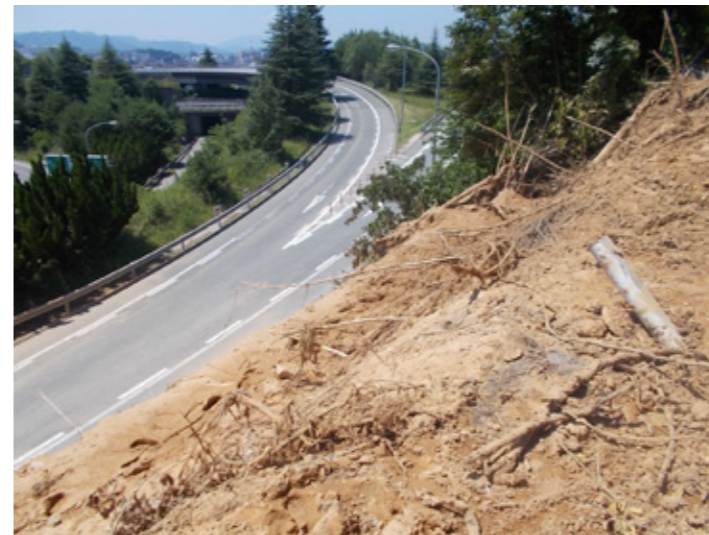
③ 西条IC近くの土石流
