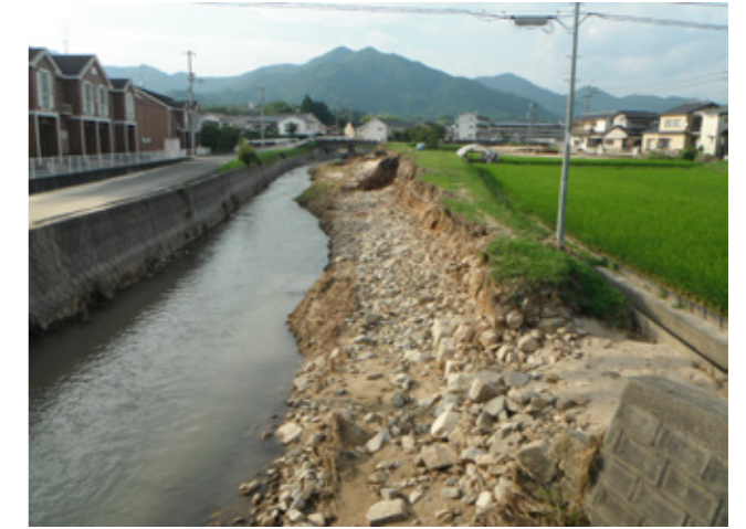
② 黒瀬川の堤防破壊
