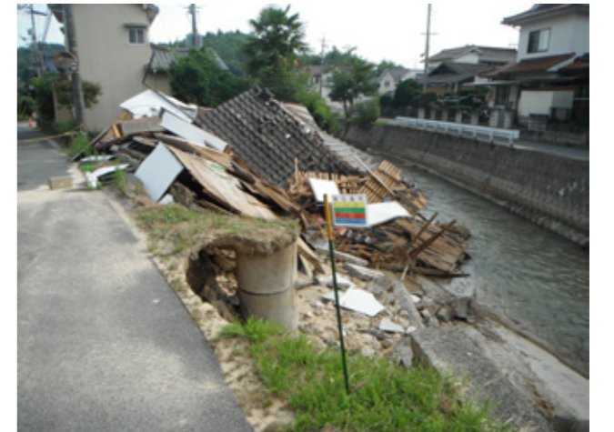
④ 米満地区の小屋の倒壊
