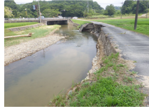
① 造賀川の堤防破壊
