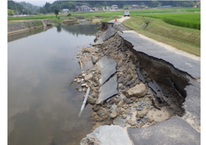
② 造賀川の堤防破壊
