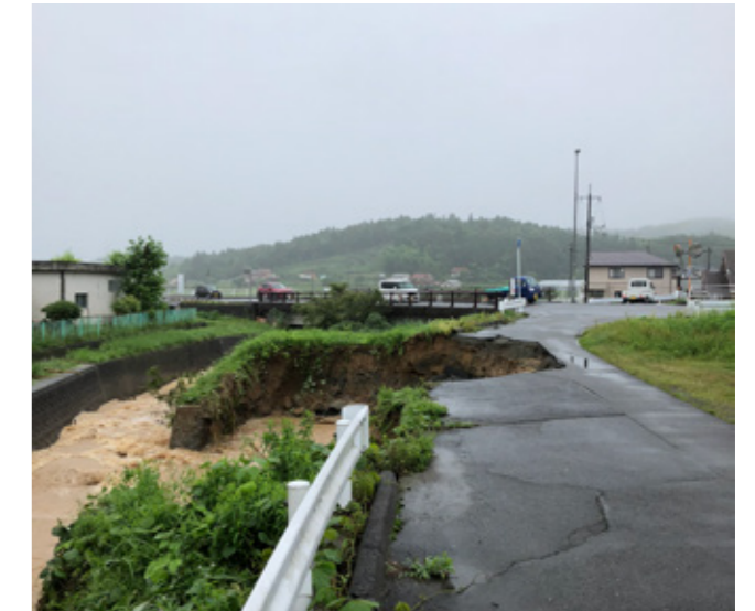
④ 造賀小学校付近の道路破壊
