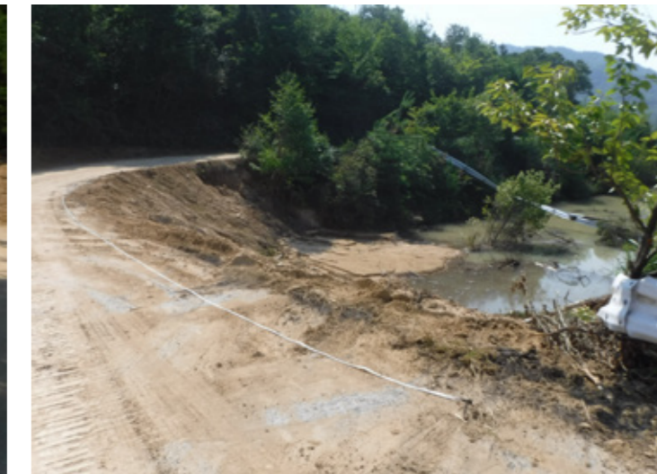
④ 黒瀬ダム付近の土石流
