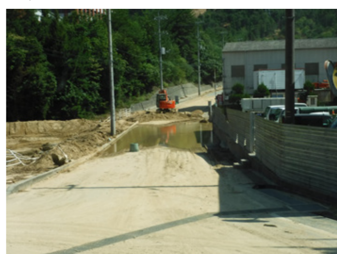
② 乃美尾地区の道路の冠水
