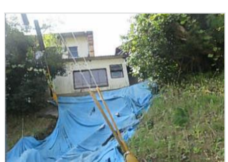
⑳住宅敷地縁からの斜面崩落
