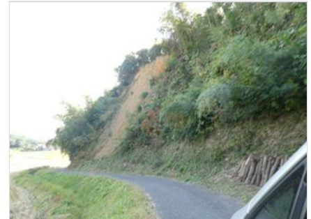
⑩道路に向かって斜面崩落
