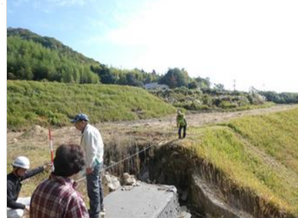
⑧2017年にも水路沿いに畔が崩落し、修復。2018年豪雨でも崩落
