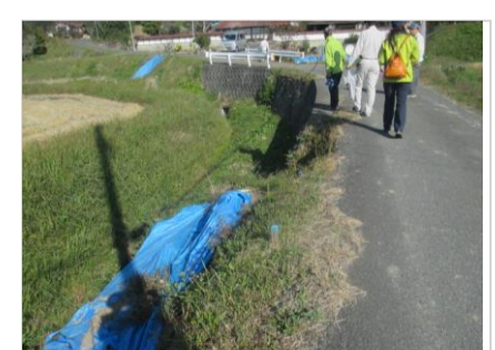
⑮集会所(緊急避難所)につながる道路が崩落
