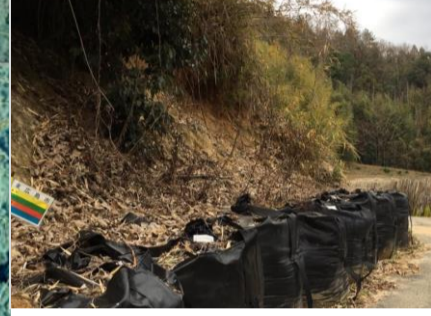
⑨のり面が崩壊した
