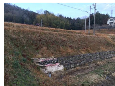
④市道の崩落(対策後)
