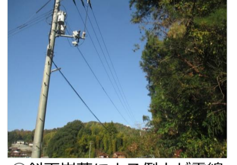
⑧ 斜面崩落による倒木が電線に引っかかり、通行不能となった
