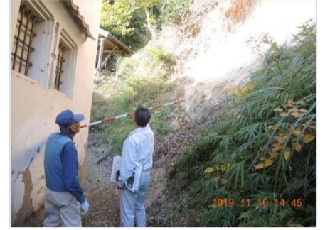
⑥ 住宅裏斜面崩壊
