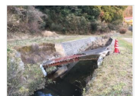
⑬ 橋の崩壊
