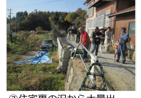
⑦ 住宅裏の沢から大量出水、床下浸水、敷地石垣崩壊し復旧した
