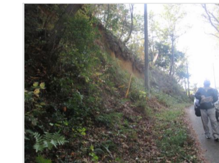
⑭ 通学路の切土のり面崩落
