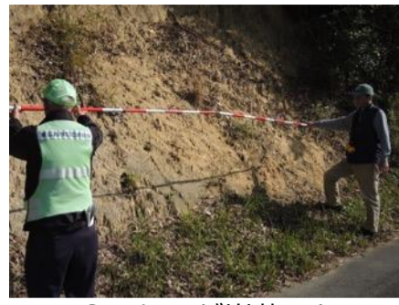
④のり面が崩落した
