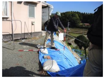
⑥崩れたのり面
