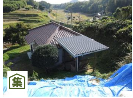
⑦中筋集会所 (屋根一部破損)
