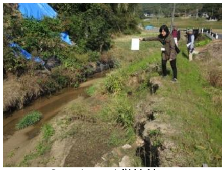
③のり面が崩落し川に流れ込んだ
