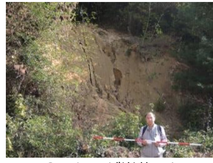
⑤のり面が崩落した
