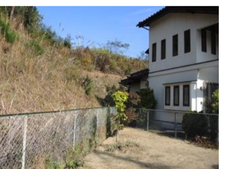
⑮のり面崩落の危険性あり
