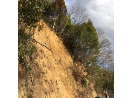
⑫斜面崩壊
