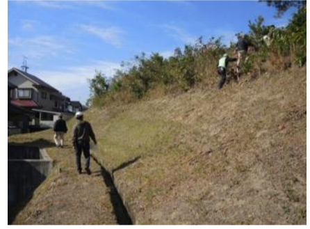
⑩水路が狭く溢れやすい。のり面崩落の危険性あり
