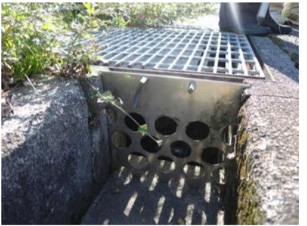
⑯側溝が詰まり溢れた
