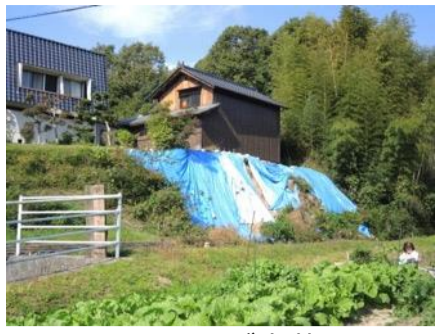
①のり面が崩落し畑に流れ込んだ
