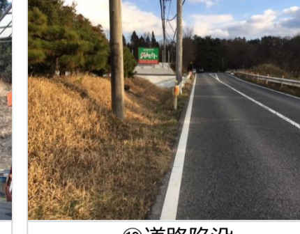
③⑨道路陥没
