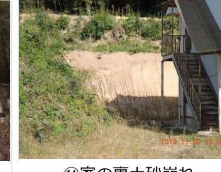
③⑭家の裏土砂崩れ
