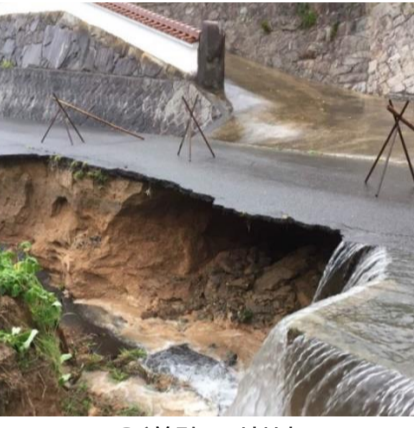
③⑥道路の崩壊
