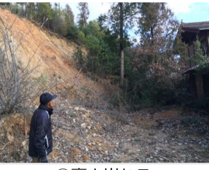
③④裏山崩れる
