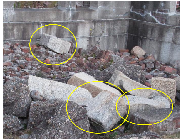
敷地内にある、落下したデンティル
