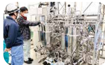
大崎上島町で導入されている二段階発酵装置
