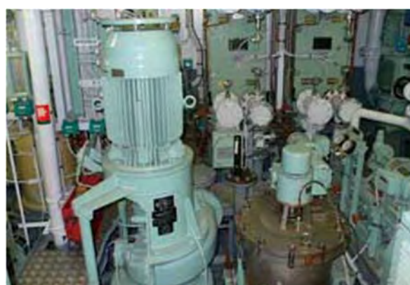
クラゲ除去装置/ Jellyfish removal system
