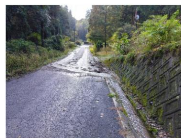
[1]土砂で埋まった側溝（福山市）
