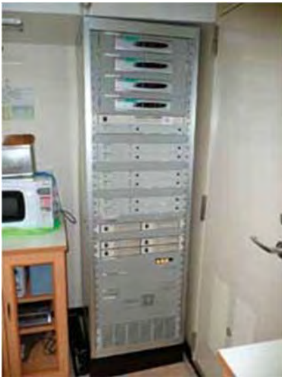
映像配信装置／Television image transmitter system
