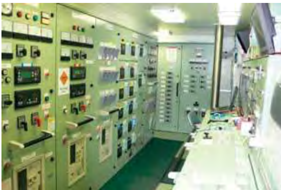
機関制御室/ Engine control room
