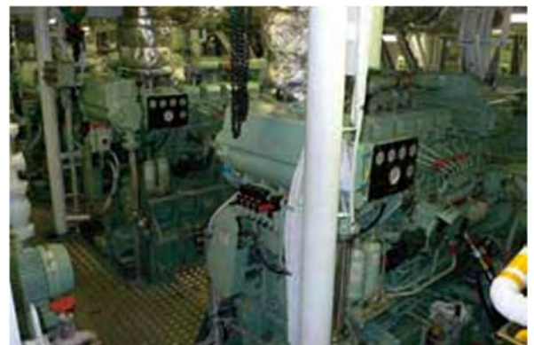
発電機関/ Engine for generator
