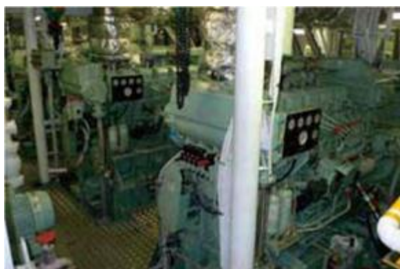
発電機関 / Engine for generator
