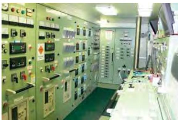
機関制御室 / Engine control room
