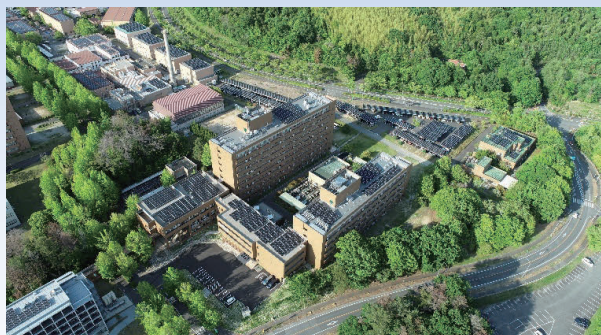
建物屋上や駐車場に設置された太陽光発電設備（生物生産学部）
