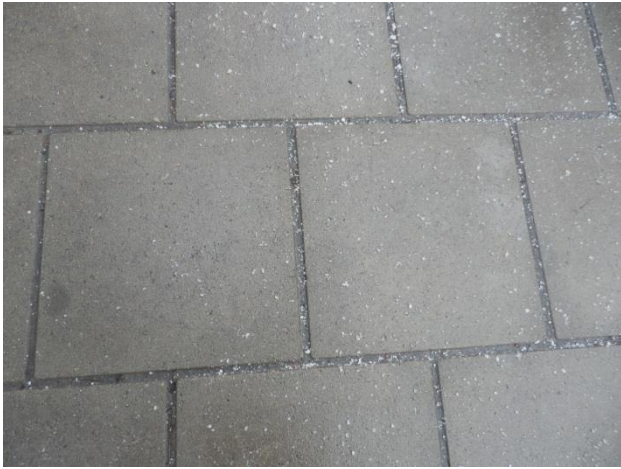
写真 1:融雪剤の撒かれたブロック舗装の歩道
