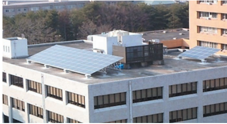
東図書館屋上設置状況（20kW）
