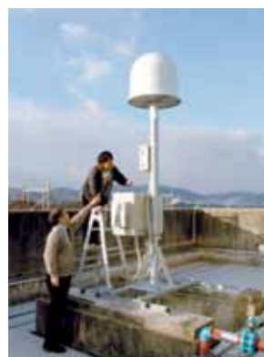
レーダシステムの設置状況 (工学研究科A2棟屋上)
