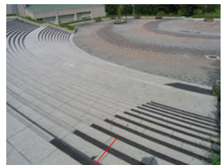
視覚障害者用段鼻仕上材が段の一部しかなく分りにくい
