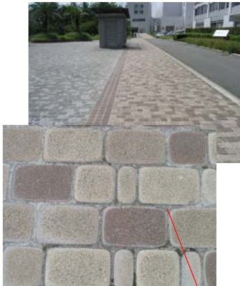
隙間が大きくハイヒール等では歩きにくい
