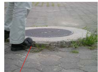
マンホール蓋廻りの地盤沈下による段差で歩きにくい
