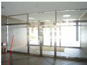
衝突防止の表示がない
