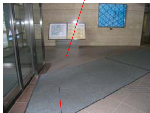
案内板への誘導ブロックがない
